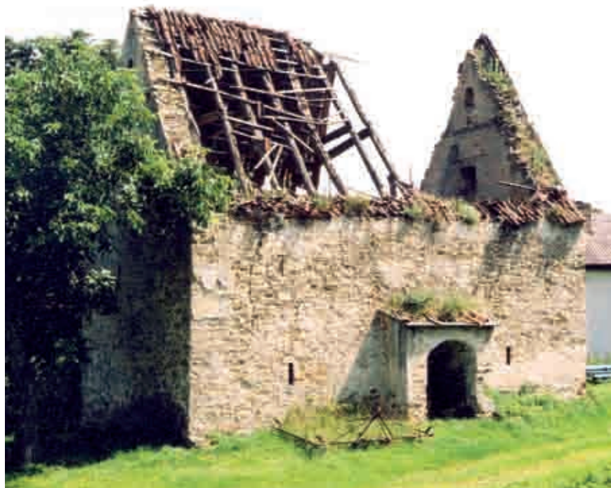
← Modlešovice, sýpka u čp. 1 s mnoha archaickými stavebními znaky, dlouhodobě zdevastovaná (JP 2001).
